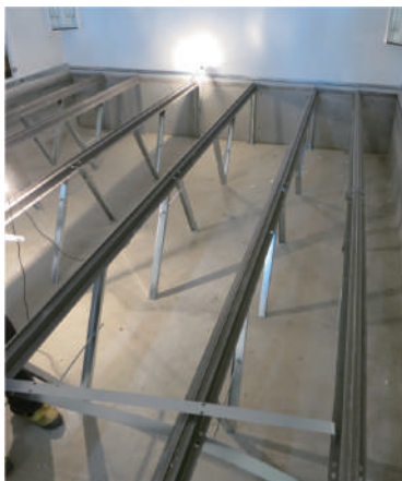
【コンクリートピット USI 架台】
