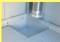
鋼板製溜め枒 鋼板製側溝
